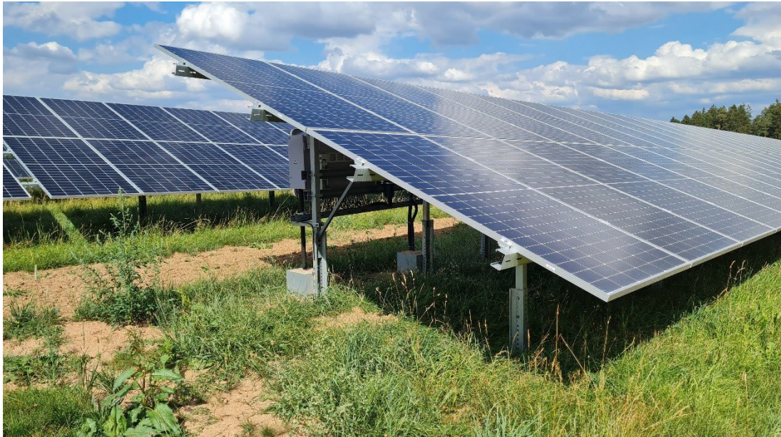
Kuva 11 Esimerkki maavaraisesta aurinkovoimala-asennuksesta. Kuva Fortum.
